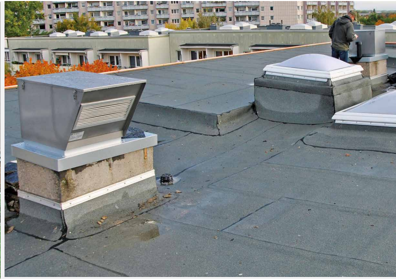
Lüftungsanlage auf dem Dach Lowetscher Straße 63–66
